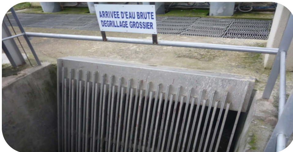
Figure II.2 : Dégrilleur (ONA. Tizi-Ouzou, 2013)
