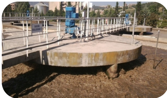
Figure II.5 : Bassin d'aération (ONA. Tizi-Ouzou, 2013)
