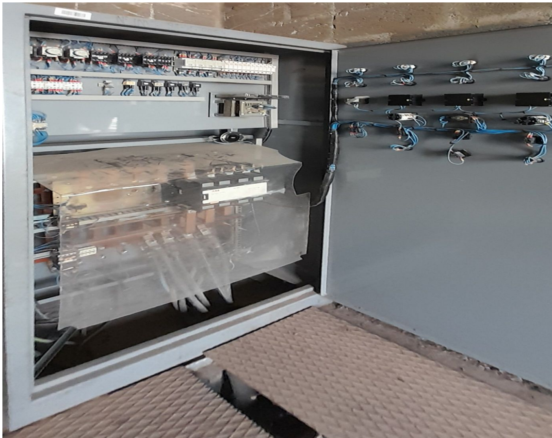
Figure 32 : Vue sur l'armoire de commande.
