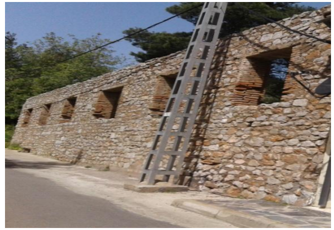
Figure 46 Des parties des murs tiennent encore mais les cadres des fenêtres n'existent plus
