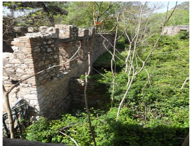
Figure 48: la végétation ferme l'accès vers le sous sol
