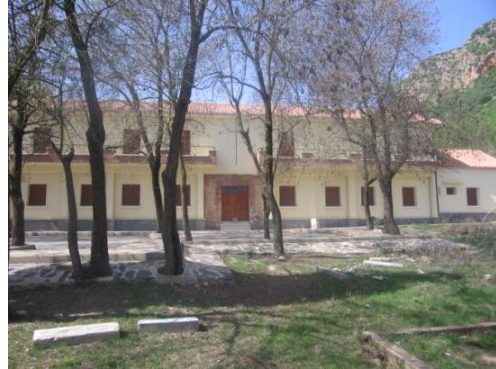
Figure 42 image sur la façade du bloc restauré source : image prise par l'auteur
