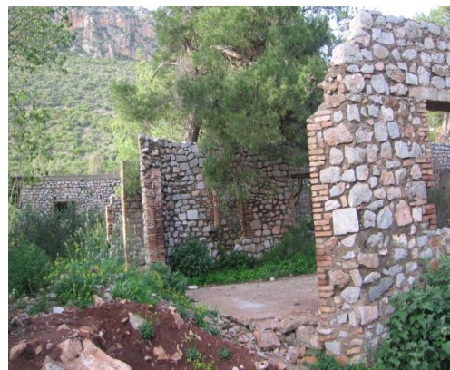
Figure44: vue sur les arrêtes endommagés source : image prise par l'auteur
