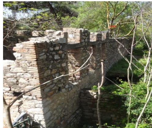
Figure43 : vue sur les murs endommagés source : photo prise par l'auteur
