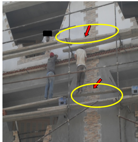
Le maçon fini le crépissage du mur du bâtiment en utilisant un échafaudage non adapté et sans équipement de prévention individuelle, ni collective
