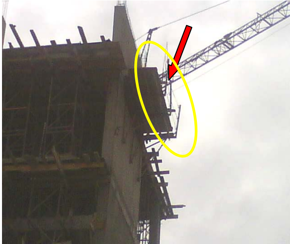
Échafaudage non protégé à hauteur de 5 ème étage
