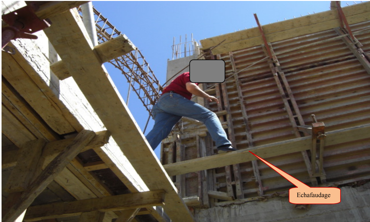
Echafaudage non conforme et sans aucune protection (un madrier)
