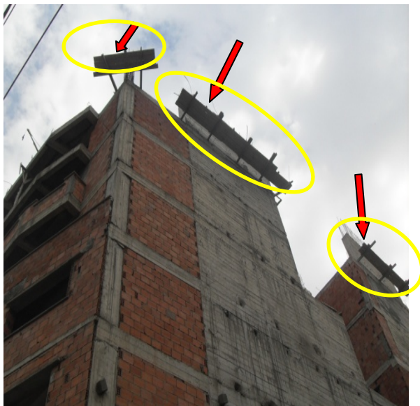
Utilisation d'un échafaudage non adapté au 5 ème étage du bâtiment
