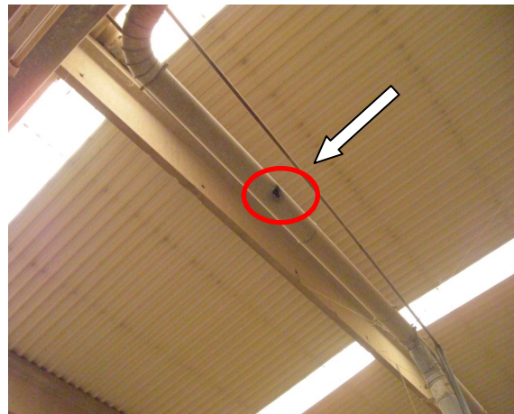
perforation du toit par une projection d'un nœud de bois
