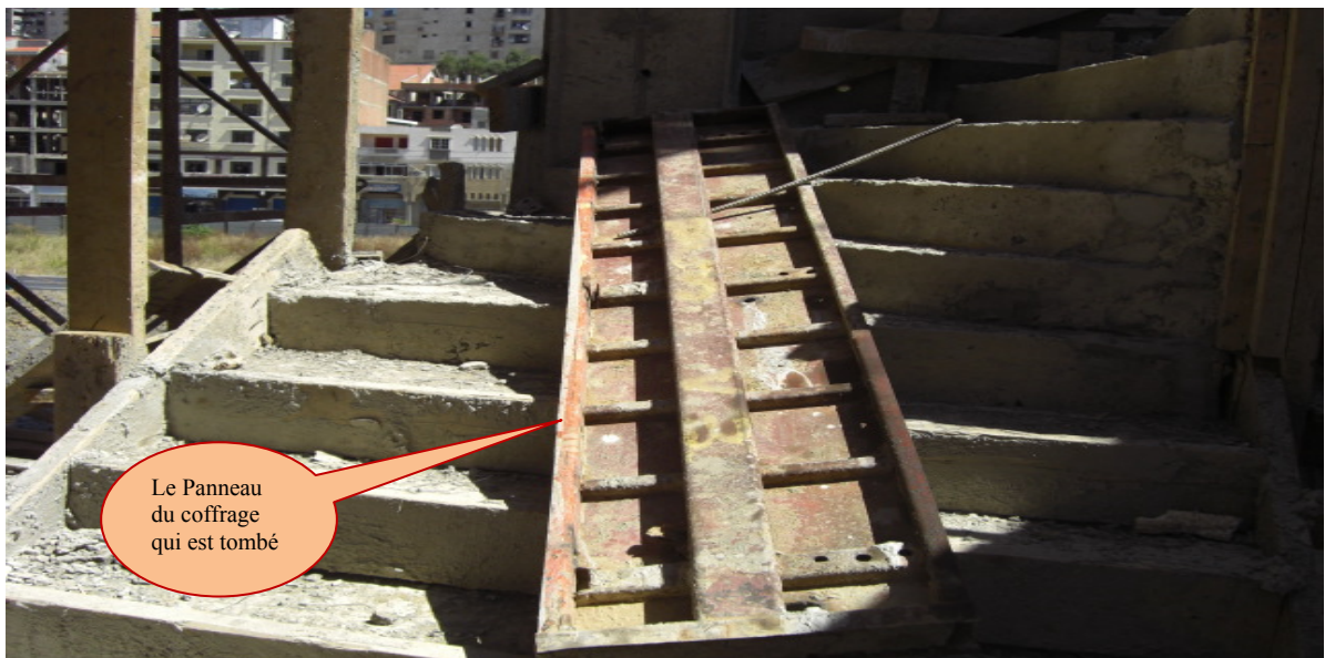
Chute du panneau du coffrage dans les escaliers du bâtiment
