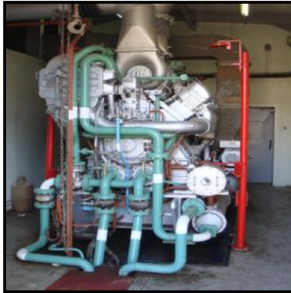
Fig. I.12 Groupe diesel de secours
