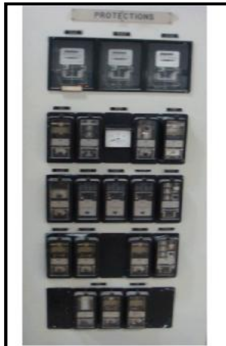
Fig.III.2 Armoire de protection d'alternateur
