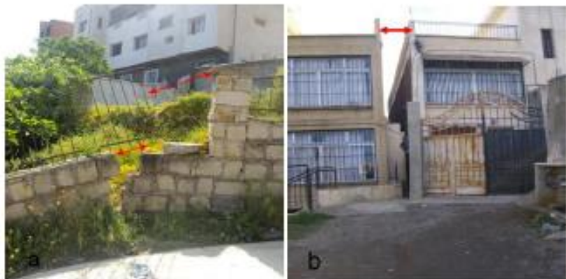
Figure 1.5 : Désordres au niveau de la ville de Tizirt (Bouaziz et Melbouci, 2014) : a) Fissuration des murs de clôture ; b) ouverture centimétrique de joints de rupture.
