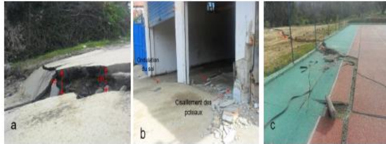
Figure 1.4 : Désordres au niveau de la ville d'Azazga (Bouaziz et Melbouci, 2014) : a) affaissements et dégradations de chaussées ; b) cisaillement au niveau des poteaux d'une construction ; c) fissures importantes sur les chaussées et la cours du nouveau centre culturel.
