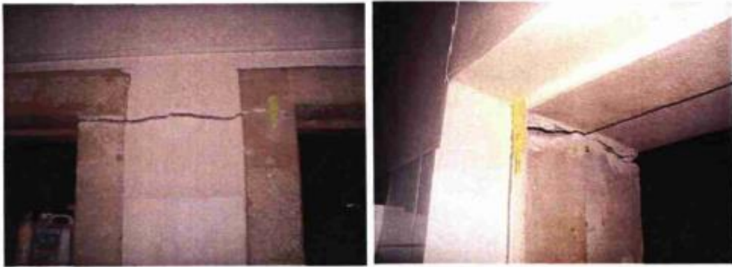
Figure 1.6 : Désordres structuraux d'un bâtiment à Montpellier (BRGM, 2005).
