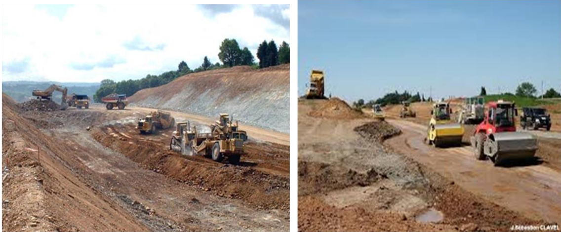
Figure 1.9 : Mise en œuvre de matériaux de remblai (à gauche) ; compactage de matériaux de remblais (à droite).
