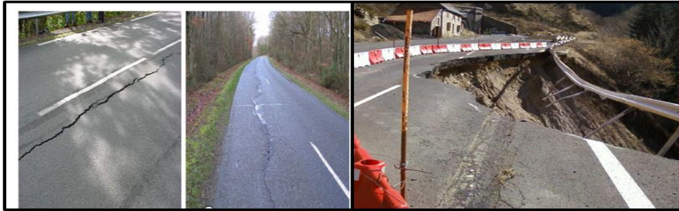
Figure 1.12 : Exemple de désordre sur remblais : Fissurations dues au retrait/gonflement (à gauche) et rupture de talus (à droite).
