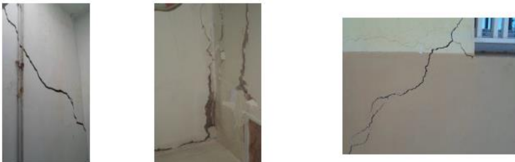
Figure 1.2 : Fissures sur des murs de bâtiments construits en 1970 (Benhamou et al., 2015).
