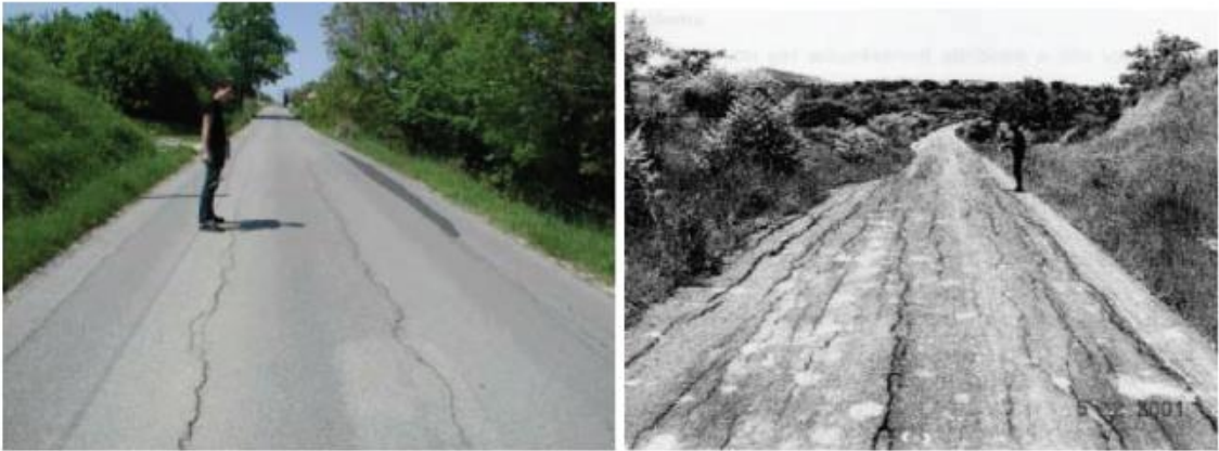
Figure 1.8 : Fissuration des routes due au retrait et gonflement des sols (Magnan, 2013) : En France (à gauche) ; à Madagascar (à droite).
