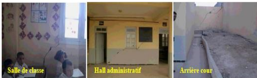
Figure 1.3 : Pathologie des maçonneries dues aux variations volumiques du sol de fondation (Khemissa et Mekki, 2007).
