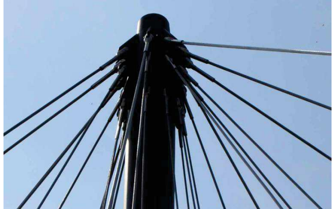
Figure V. 40 : Les câbles en acier inoxydable
