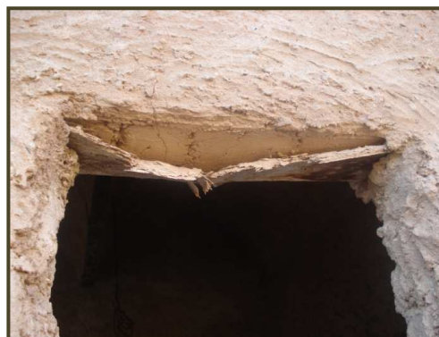
Photo III.17 : Rupture du linteau, Tamarna Lakdima (Source : Auteur)
