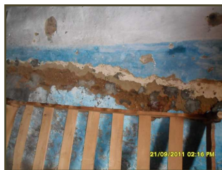
Photo III.3 : Dégradation due à la condensation superficielle, Beni Yenni (Source : Auteur).
