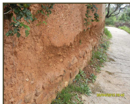
Photo III.2 : Dégradation à la base du mur en pisé à cause des remontées capillaires, Maatkas (Source : Auteur).
