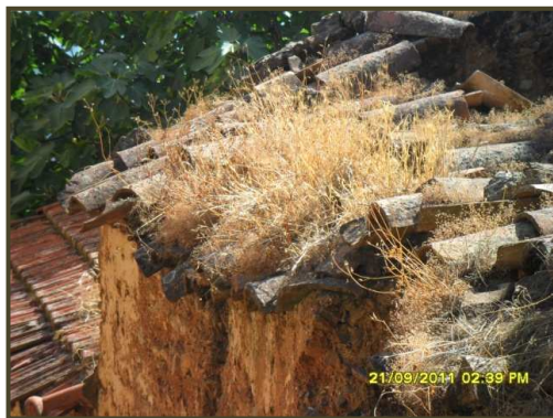
Photo III.22 : Colonisation de la couverture par la végétation, Beni Yenni (Source : Auteur).
