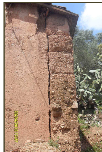
Photo III.16 : Fissure d'angle dite de « coup de sabre », Maatkas (Source : Auteur).
