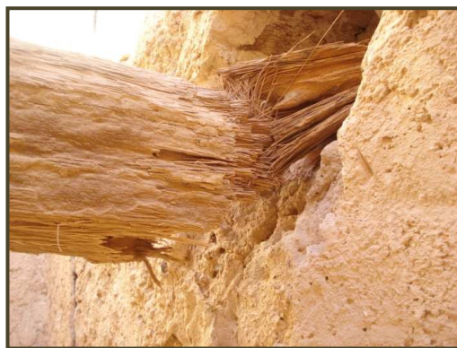
Photo III.21 : Rupture de la poutre par attaques d'insectes, Tamarna Laktima (Source : Auteur).
