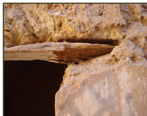
Photo III.8 : Dégradation du linteau sous l'effet de l'humidité, Tamarna Lakdima (Source : Auteur).
