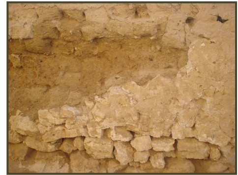
Photo III.10 : Déchaussement des briques de terre crue, Témacine (Source : Auteur).
