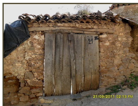
Photo III.19 : Dégradation de la menuiserie de la porte, Beni Yenni (Source : Auteur).
