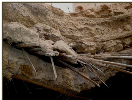
Photo III.20 : Fléchissement du plancher, Témacine (Source : Auteur).
