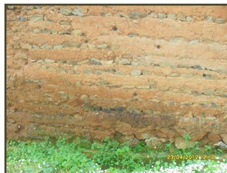
Photo III.1 : Humidité par remontées capillaires, Maatkas (Source : Auteur).
