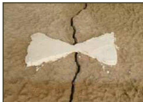
Photo IV.3 : Témoin en plâtre sur une fissure. (Source : Moriset S)
