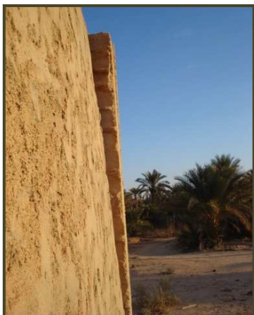
Photo III.11 : Déversement du mur vers l'intérieur, Tamarna Lakdima (Source : Auteur).
