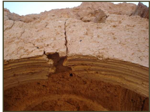
Photo III.25 : Fissuration de la clé de l'arc, Témacine (Source : Auteur).
