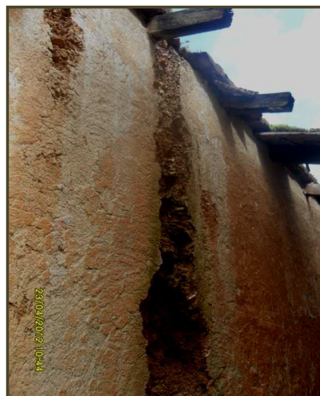
Photo III.4 : Dégradation du mur à cause d'une humidité accidentelle, ici, défaut dans la toiture, Maatkas (Source : Auteur).
