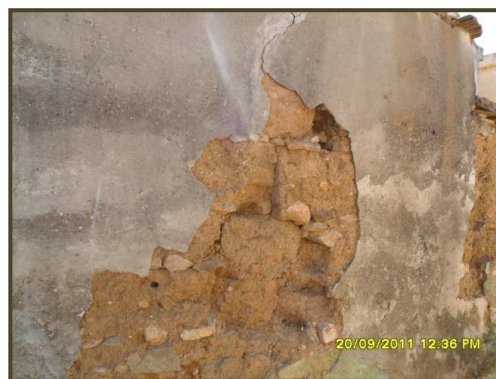
Photo III.5 : Dégradation du mur en terre sous l'enduit de ciment, Maatkas (Source : Auteur)
