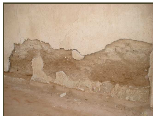
Photo III.24 : Décollement de l'enduit, Maatkas (Source : Auteur).
