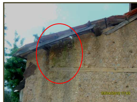
Photo III.7 : Moisissures sur le mur en pisé, Maatkas (Source : Auteur).
