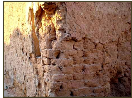
Photo II.29 : Liant à base de chaux, El-Oued (Source : Auteur).
