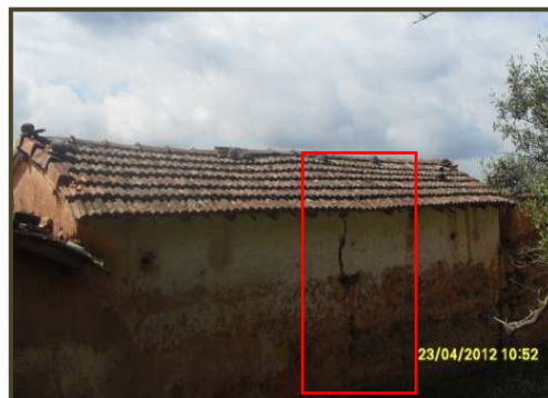
Photo III.15 : Fissure de poinçonnement due à la poussée du chevron de la charpente, Maatkas (Source : Auteur).
