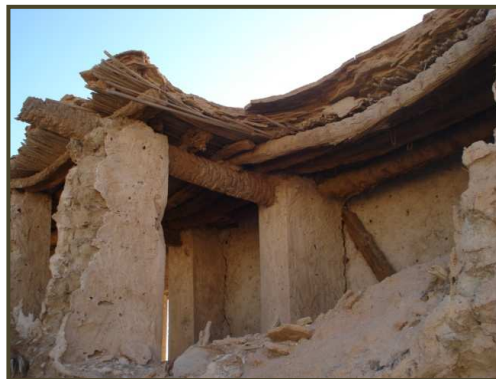
Photo III.23 : Effondrement de la couverture, Témacine (Source : Auteur).
