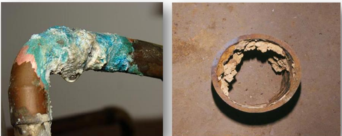
Fig V-19. Corrosion des conduites
