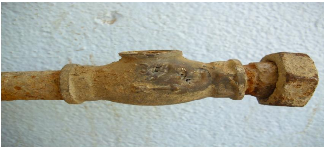
FigV-20 .Conduite corrodée (corrosion interne)
