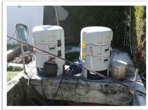
Figure VII.1. Installation d'un préleveur pour la mise en œuvre d'un bilan ponctuel
