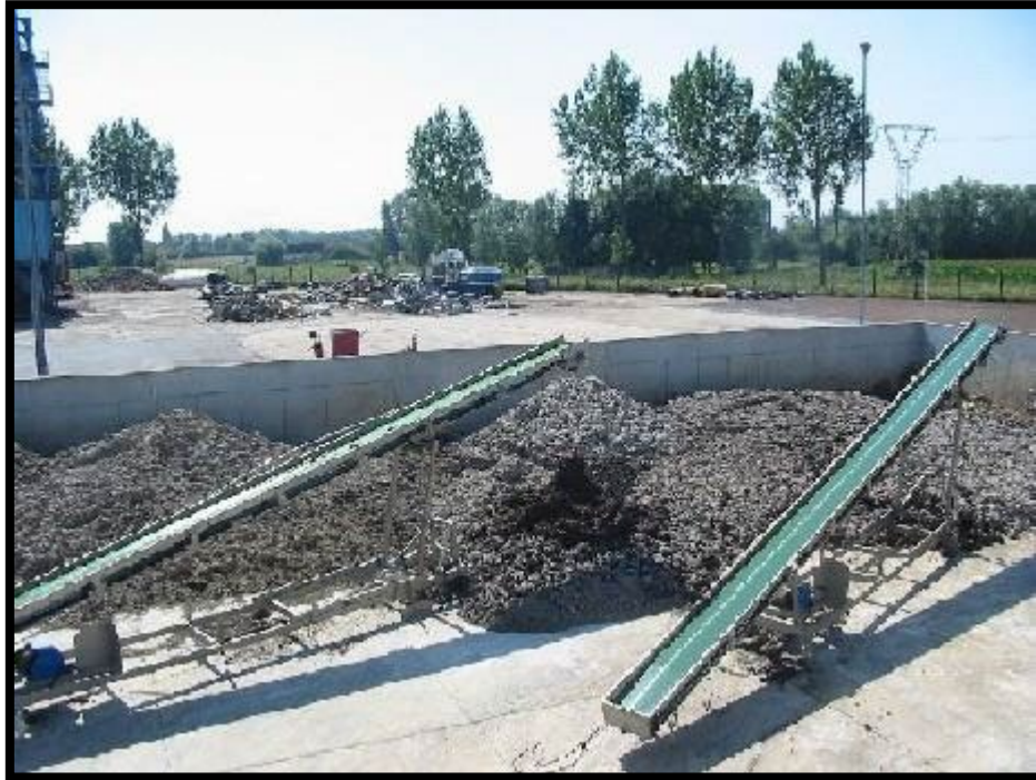
Figure III.3 récupérations des boues épaissies
