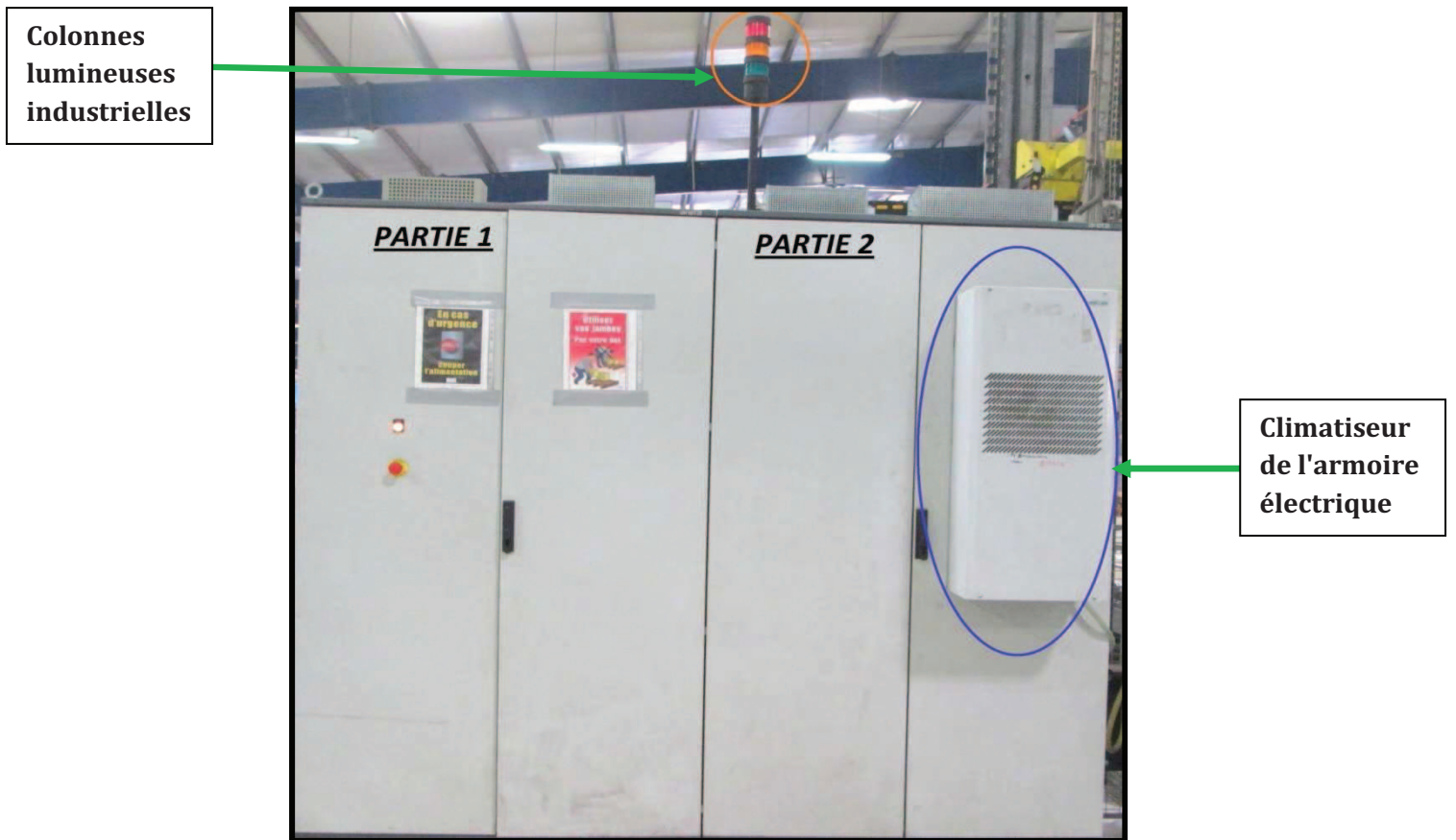
« Figure I-13 » : Armoire électrique de la machine.
