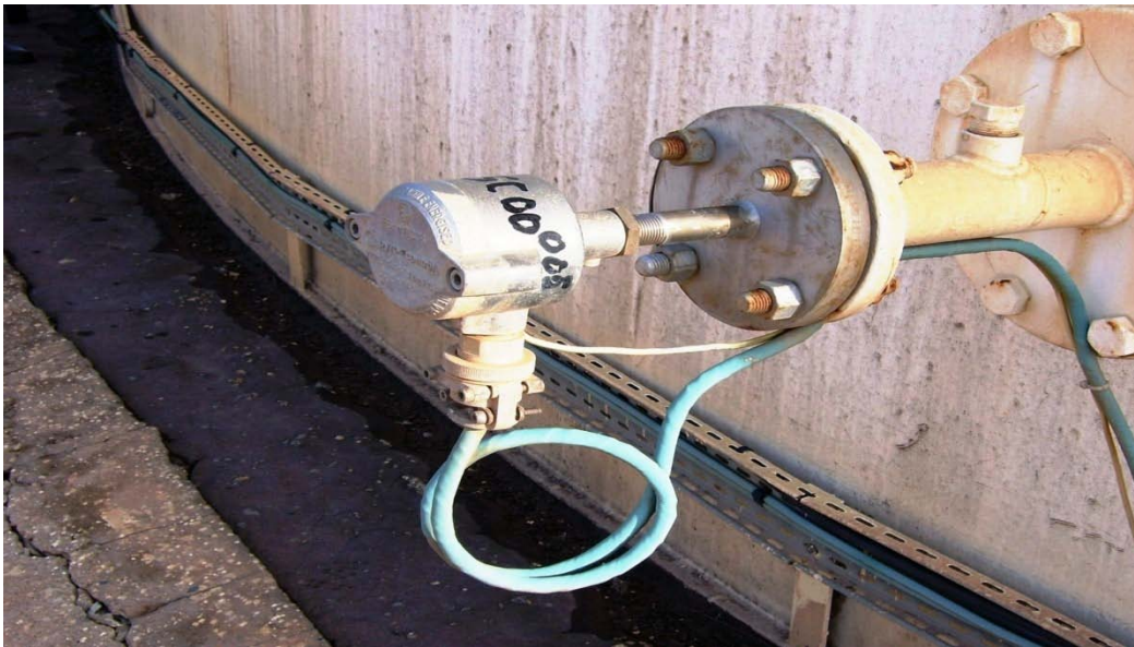
Figure 4: Installation de la sonde PT100 au CSD [5]
