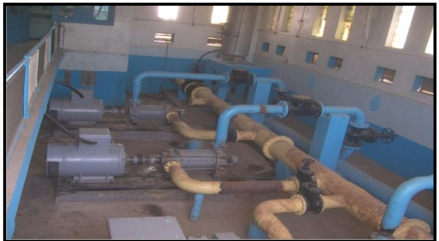
Figure II.5: Groupes électropompes de la station de pompage « Pont noir »
