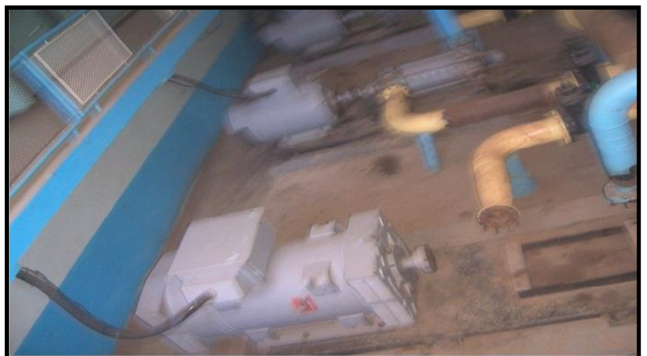
Figure II.6: Groupe électropompe de secours en panne
