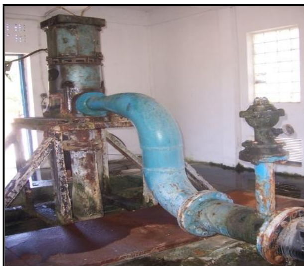
Figure II.1 : Puits P 2 équipé d'un GEP à axe
