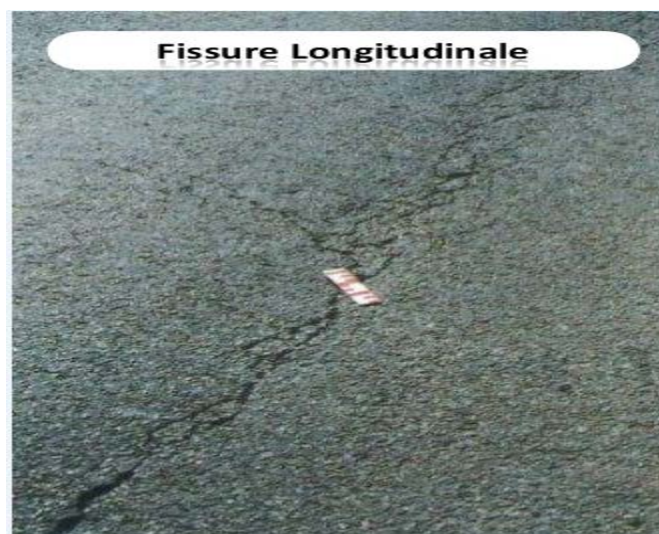
Figure I.15. fissure longitudinale (catalogues des chaussées)
