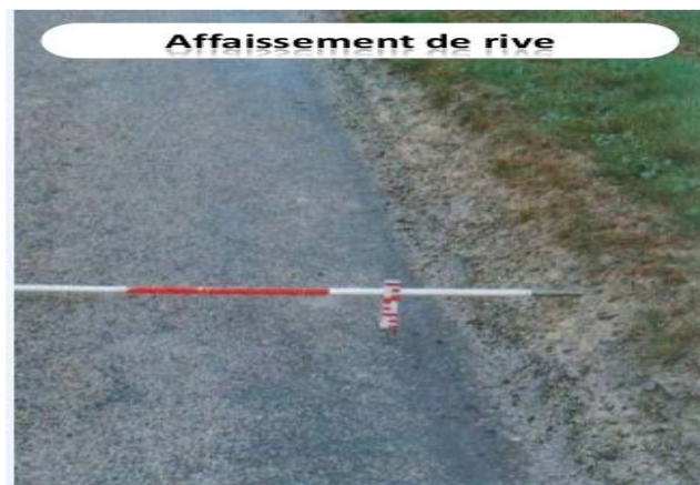
Figure I.12. affaissement de rive (catalogues des chaussées)
