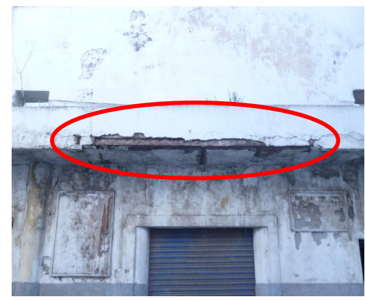
Dégradation de la façade Source : Auteur
