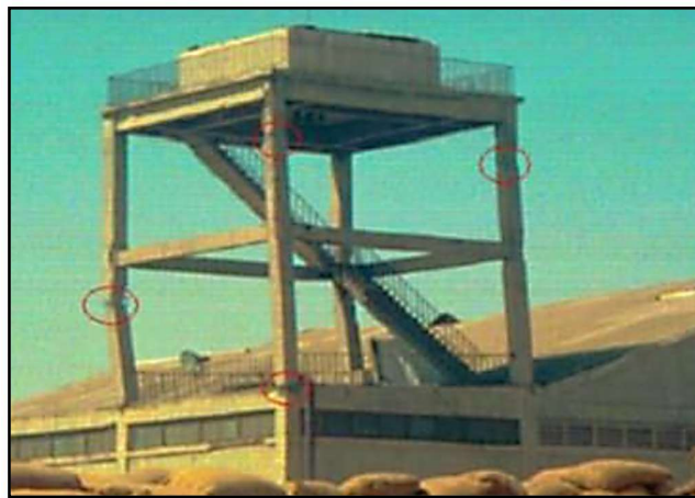
Figure I.9: Endommagement d'un portique à 2 étages dans les zones critiques des poteaux dans une installation portuaire lors du séisme de Buhj (Inde) en 2001.
