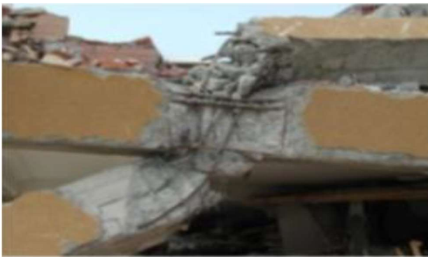
Figure I. 20 : Rupture en zone nodale [18].
