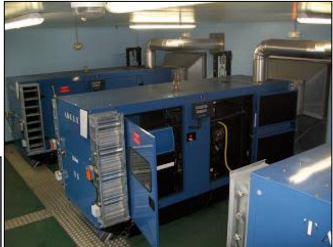
Figure 111: Groupe électrogène au niveau du local électricité
