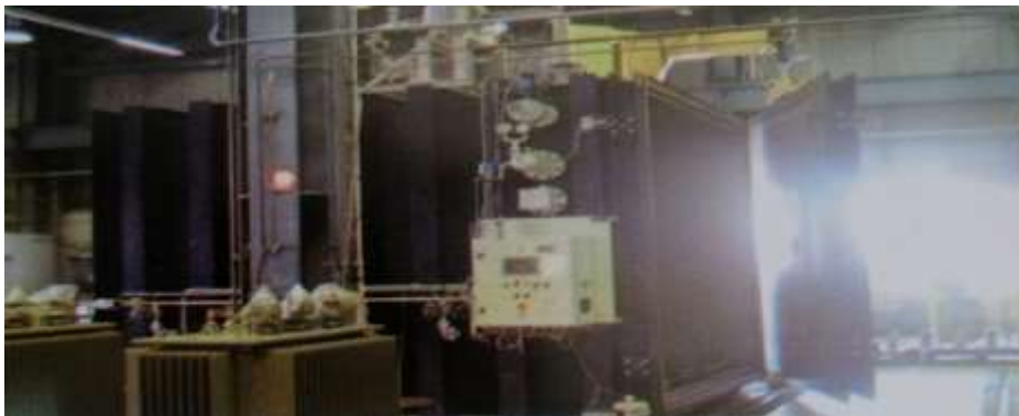
Figure n°25 : Four de remplissage sous vide
