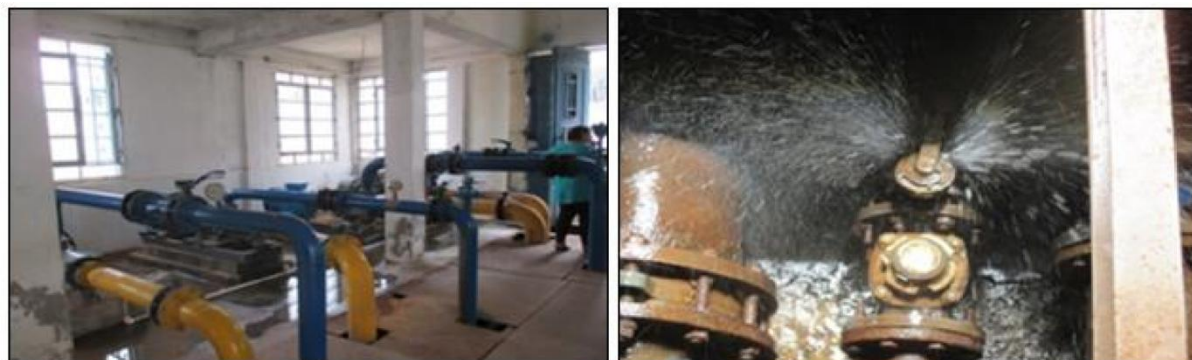
Figure I.4 : Vue d'intérieur de la Station de pompage.
