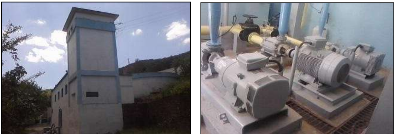
Figure III.8: Réservoir d'arrivée et station de refoulement
