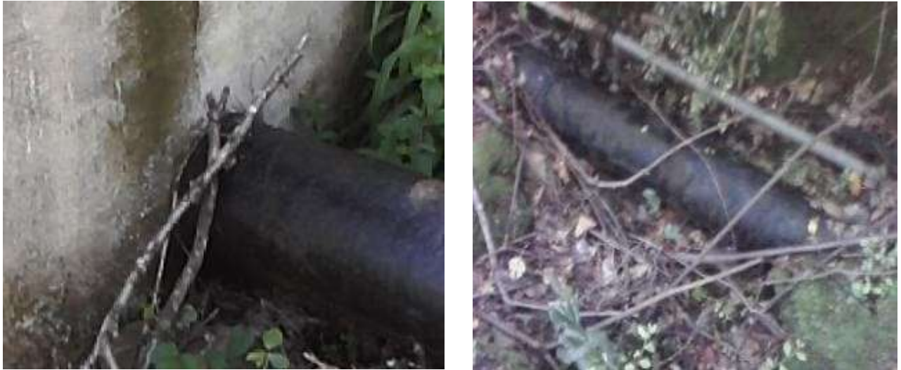
Figure III.7 : Les conduites utilisées
