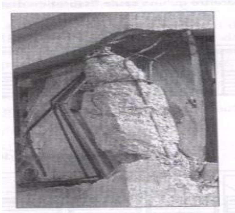
Figure I.6: Cisaillement d'un poteau court (séisme d'Izmit, Turquie, 17 août 1999)
