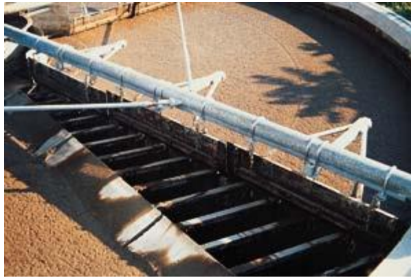
Figure 7.4: Épaississement des boues par flottation.
