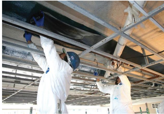
Figure I.2 : Renforcement en flexion de dalle par FRP
