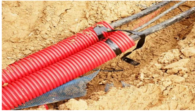
FIGURE 1.8 – Câble à fibre souterrains
