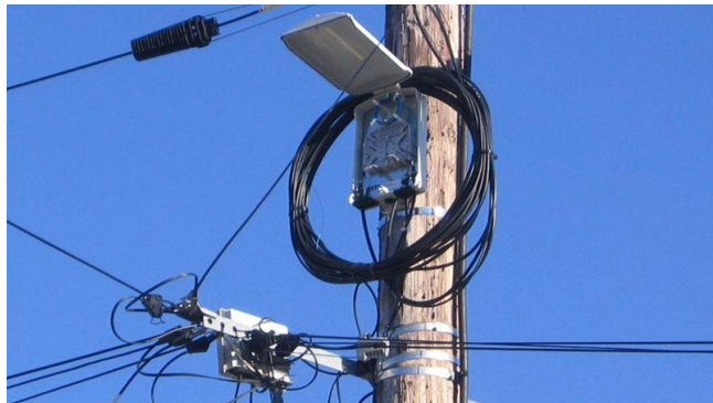
FIGURE 1.10 – Câble à fibre aériens
