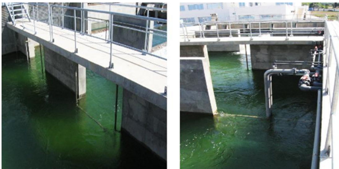
Figure 8 : Chambre de mélange
