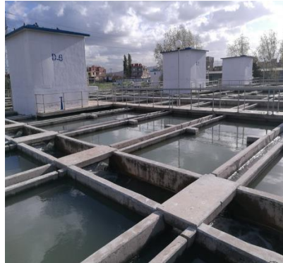
Figure I.7 : Décanteurs pulsator lamellaire.
