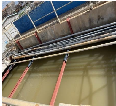
Figure I.5 : Chambres de mélange.
