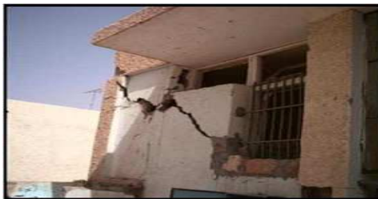
Figure II.18 : Fissure sur les murs et Fissures diagonales. Ferrah (2006)
