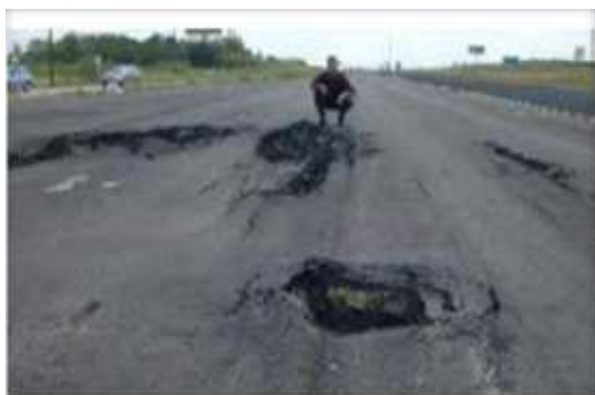
Figure II.22 : Dégradation des routes (freeah 2006).
