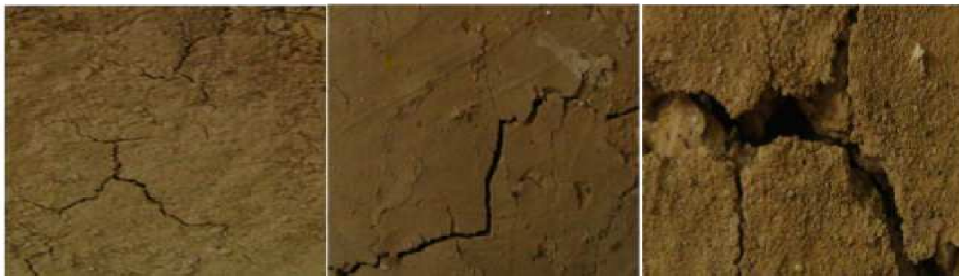
Figure II.31: développement des fissures.
