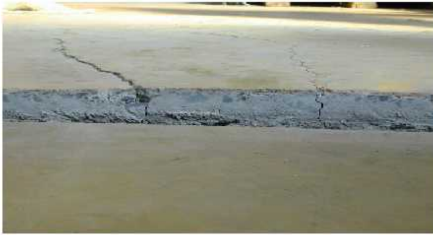
Figure II.12. Gonflement d'une chaussée.
