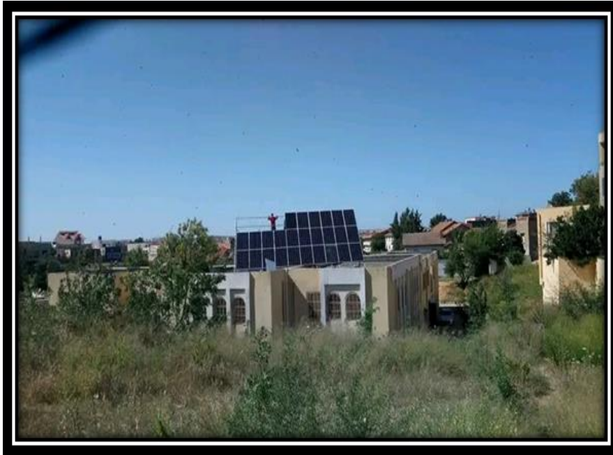
Figure 16: installations des panneaux solaires école primaire Avenhyd
