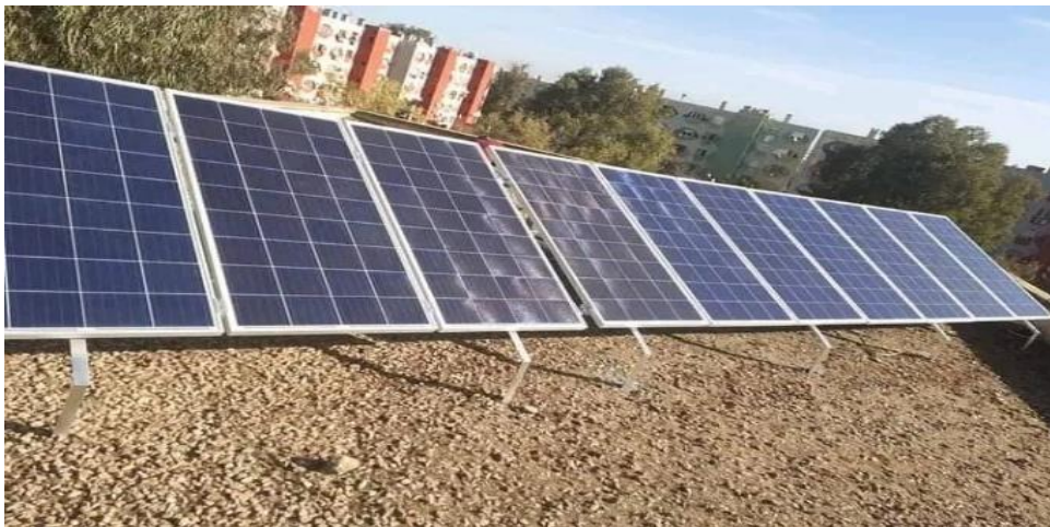
Figure panneaux solaires dans une école primaire
