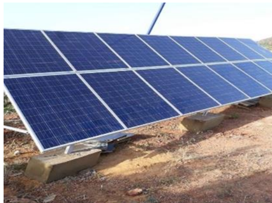
Figure 34: : panneaux solaires école (2)
