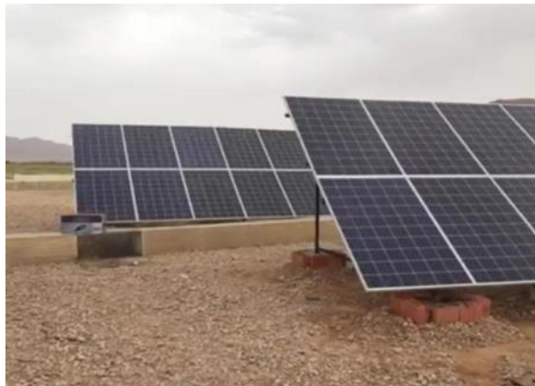
Figure 24: : Station solaire au sud d'Alger
