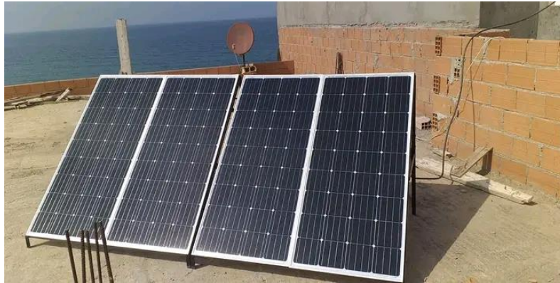
Figure 25:Alimentation d'un foyer en énergie solaire
