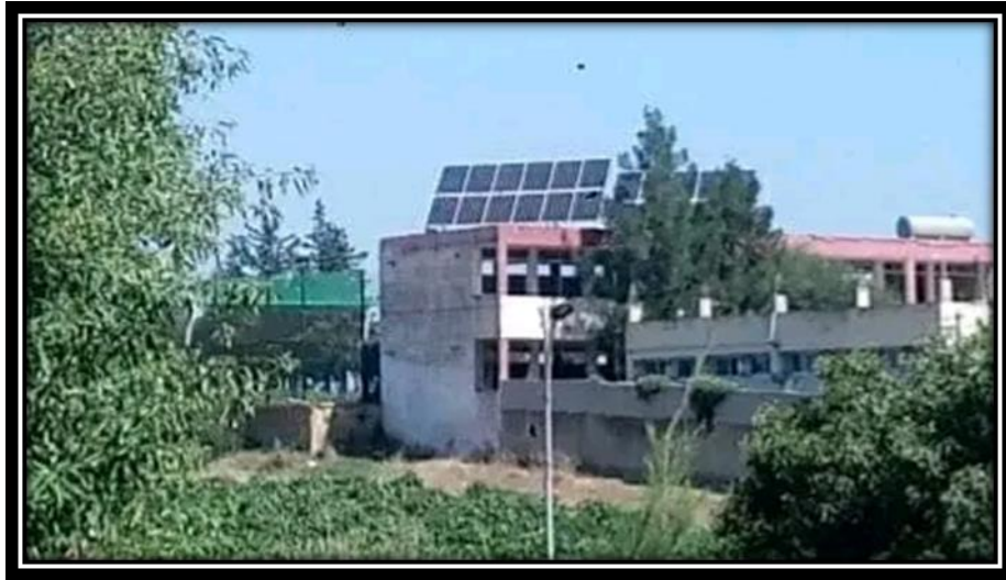
Figure 18: installations des panneaux solaires école primaire (2) Avenhyd
