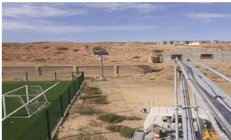
Figure 26: Éclairage solaire dans un stade
