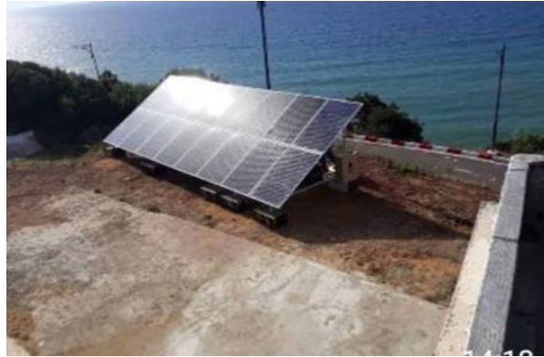
Figure 33: : panneaux solaires école (1)
