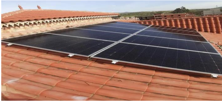
Figure 32: panneaux solaires sur toile
