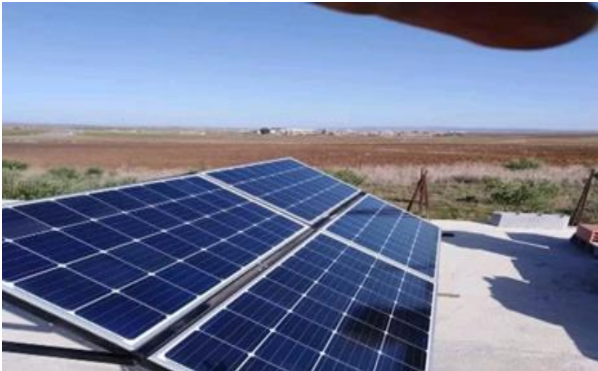
Figure 12:panneaux solaires pour une zone agricole « SPS »
