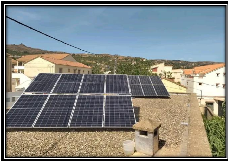
Figure 20: : Installation Photovoltaïque à l'école primaire Agouni Ofekous, Boudjima,
