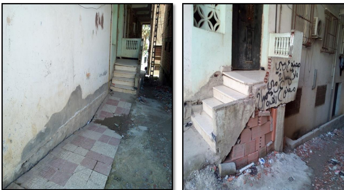
Figure I.15. Désordres due au gonflement (Photo prise à Tizi-Ouzou)
