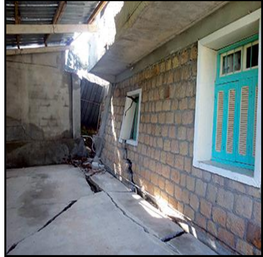
Figure I.18. Fissuration d'une maison lors d'un glissement de terrain (Azazga) [15]
