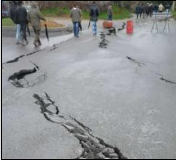
Figure I.17. Fissuration d'une route provoquée par un glissement de terrain (Azazga) [14]
