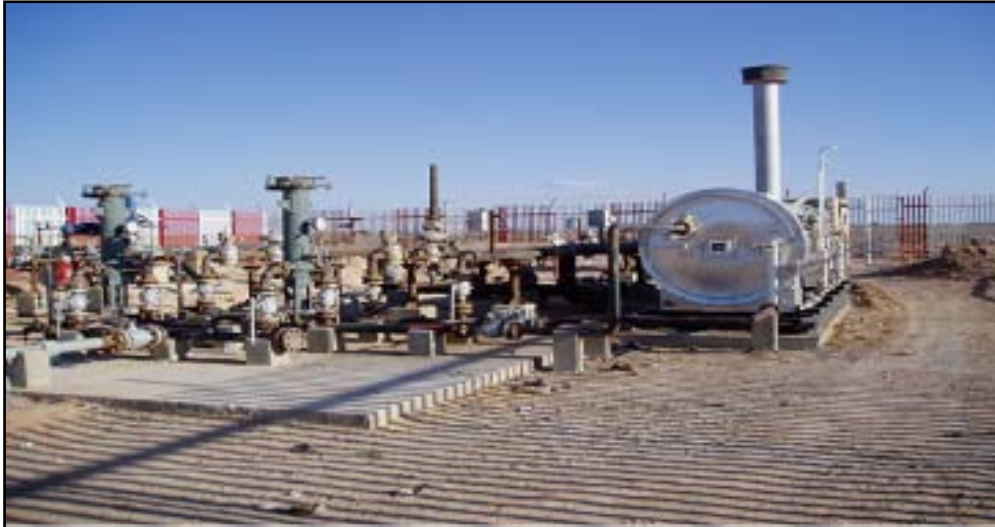
Figure I.6 : Vue d'un poste de détente avec réchauffeur
