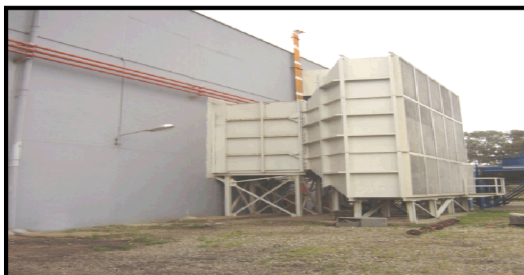
Figure I.7 : Système d'admission d'air centrale Bab Ezzouar
