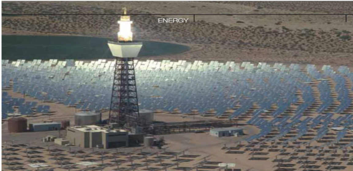
Figure II.4 : Centrale à tour solaire à héliostats. [5]
