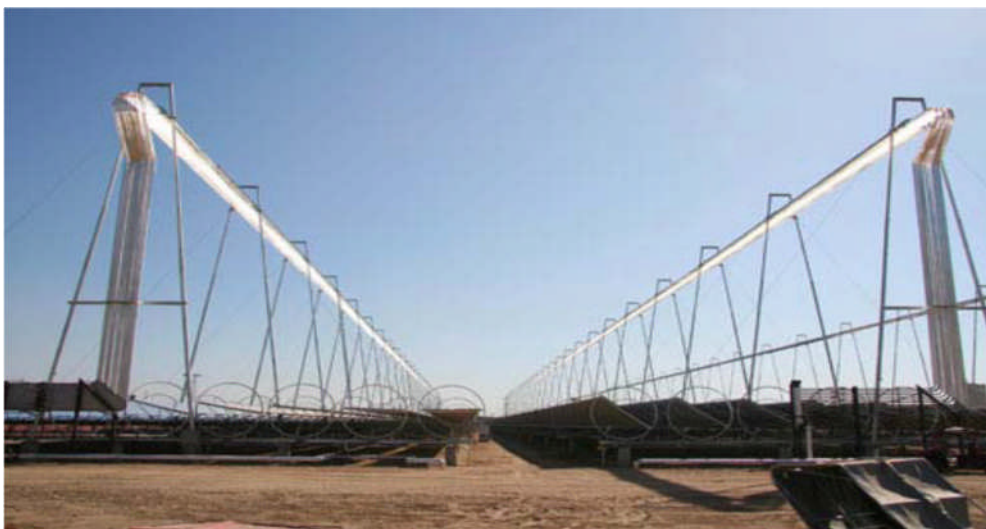
Figure.II.10 : Centrale de Kimberlina, par Ausra. [11]
