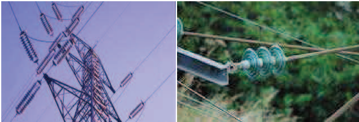
Fig. I.1 A gauche : Pylône double drapeaux et chaînes d'isolateurs en verre d'ancrage [1]. A droite : une chaîne d'isolateur [2].
