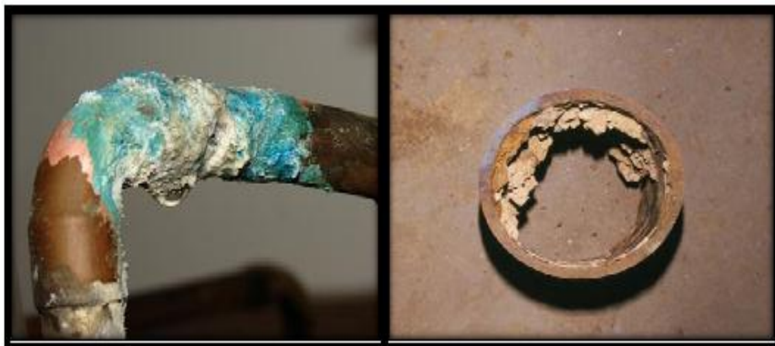
Figure (IV.15) : la corrosion dans les conduites
