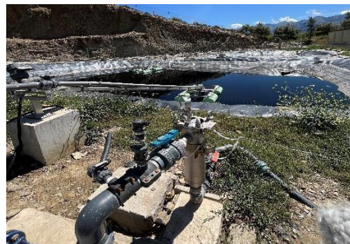
Figure 15 : Système de pompage des lixiviats) vers la station de traitement (Original, 2025)
