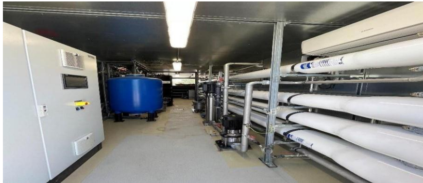
Figure 16 : Station de traitement des lixiviats par osmose inverse (Original, 2025).
