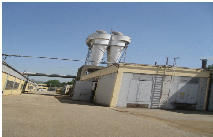
Photo 27 : Réseau d'aspiration centrale des poussières de bois
