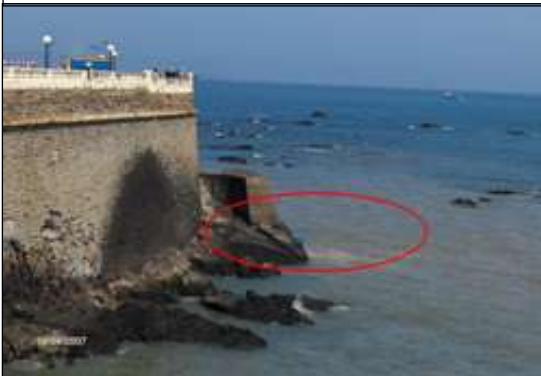
Figure 86: Les eaux usées collectées par le réseau sont acheminées directement vers la mer.
