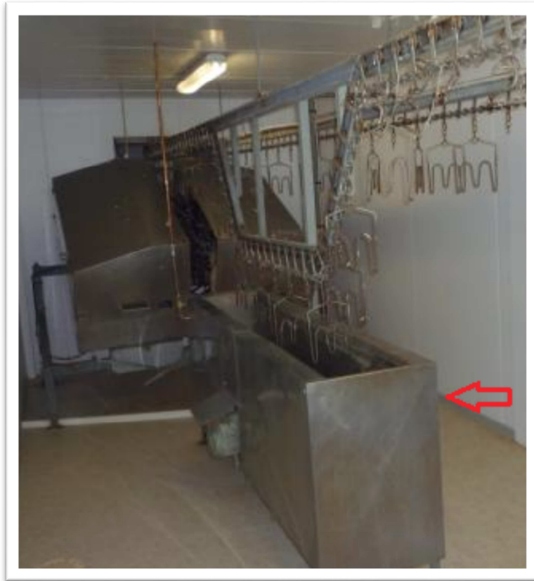
3- Cuve à échaudage (flèche rouge)
