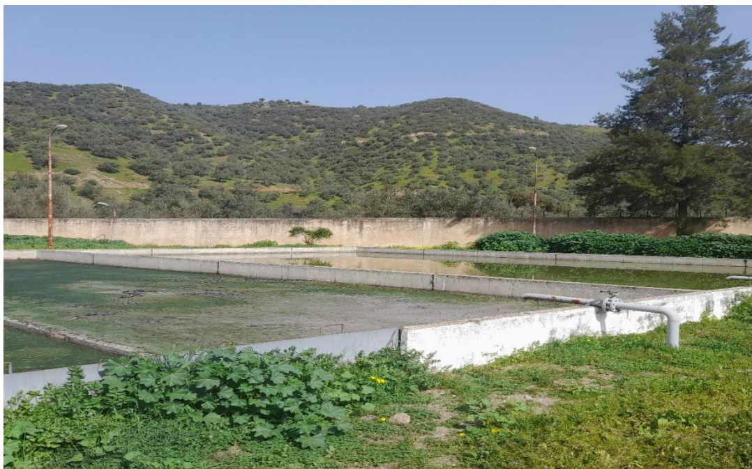
Figure 1.11 : Lit de séchage (station de Boghni)
