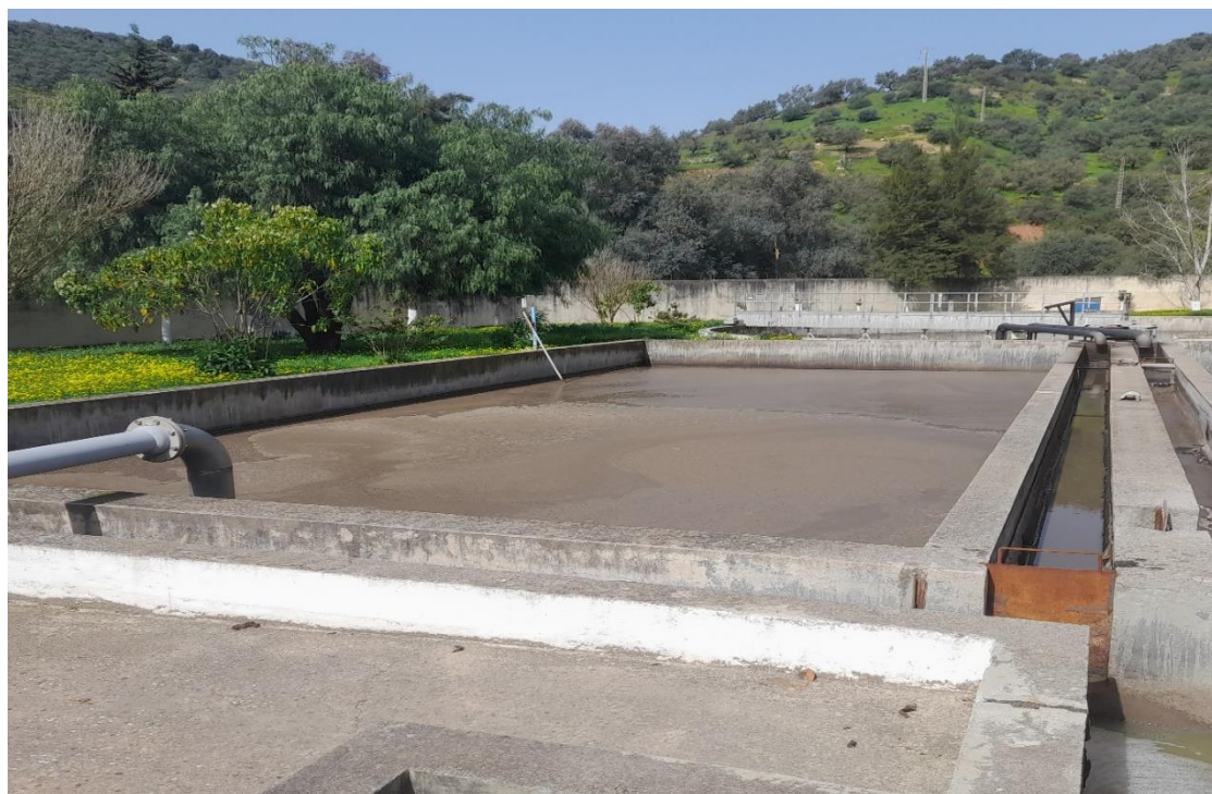
Figure1.8: Bassin d'aération (station de Boghni).
