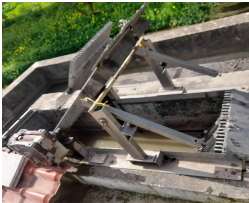
Figure 1.5 : Dégrilleur (station de Boghni).
