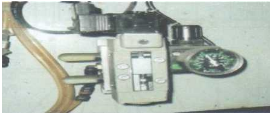
Figure 3 : Electrovannes Electropneumatique Y100 et Y101
