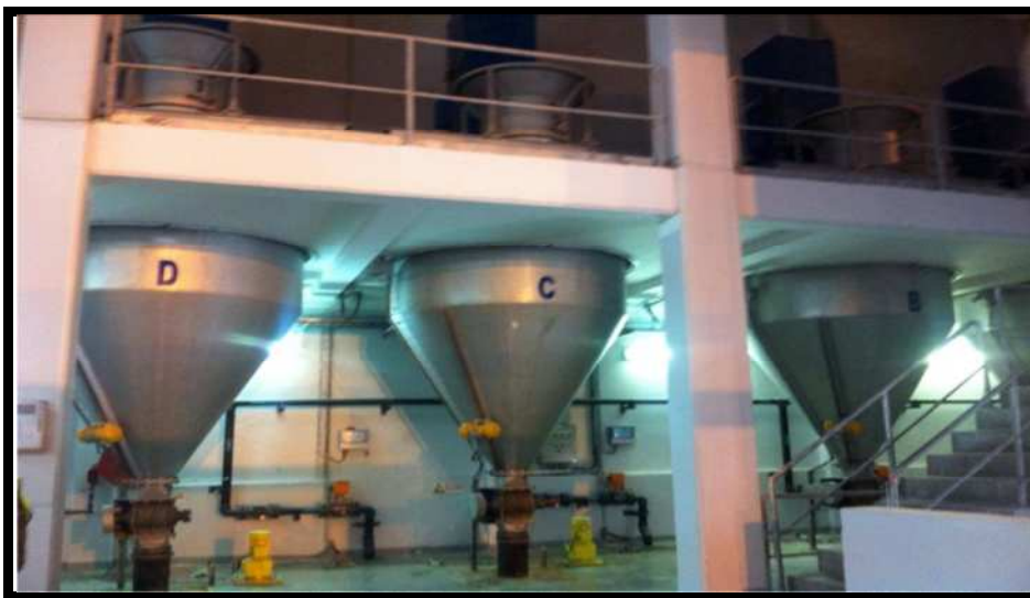
Figure 01. Cuve de préparation et dosage de sulfate d'alumine
