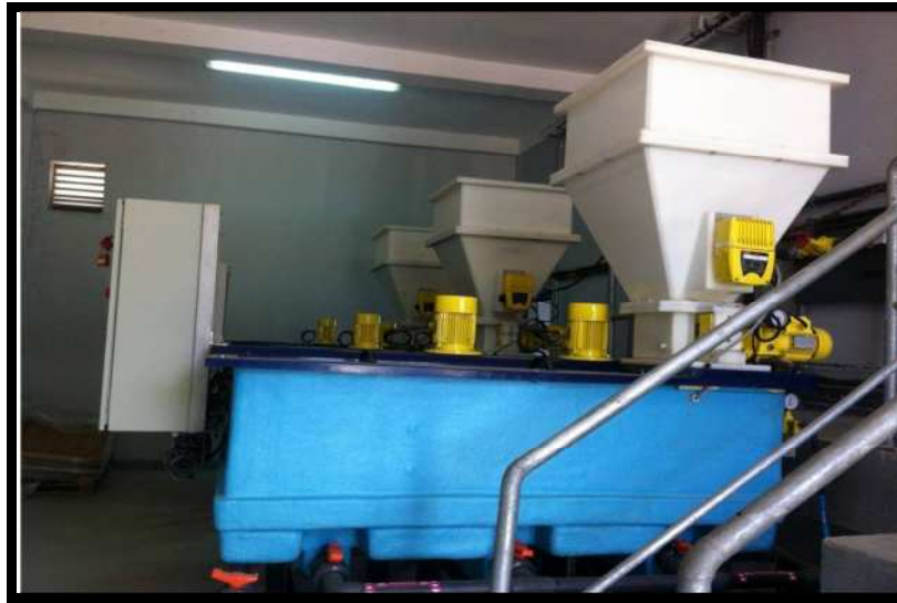
Figure 02. Cuve de préparation des polymères
