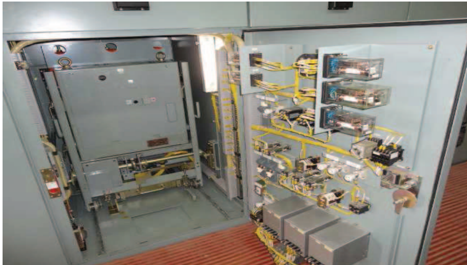
Figure (IV.2) : Cellule électrique
