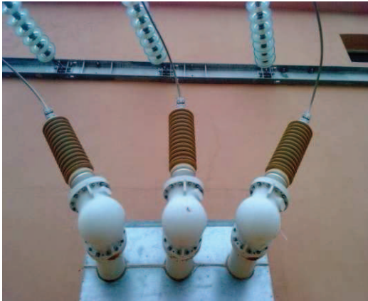
Figure(III.4) : L'arrivée de la ligne 60kv
