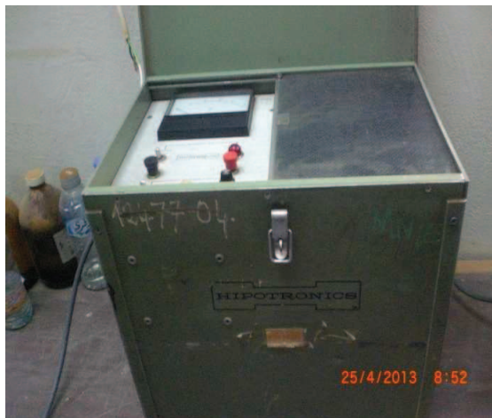
Figure (1) : Régulateur de tension
