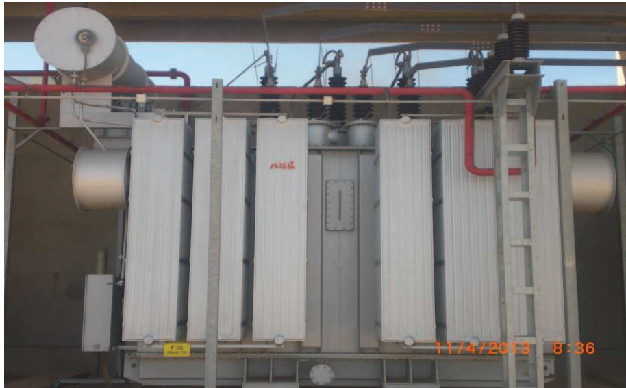
Figure(III.8) : Transformateur électrique
