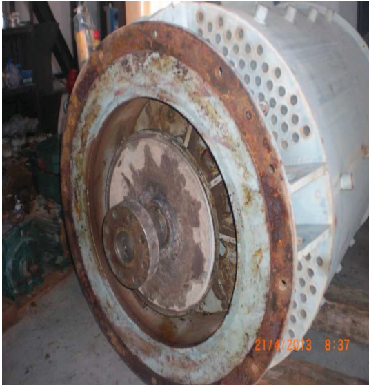
Figure(4) : Moteur 5,5Kv
