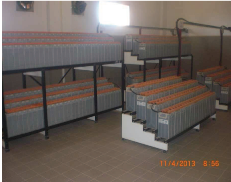
Figure(III.9) : les batteries
