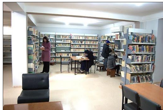
Figure 23 : Climatisation monobloc à la bibliothèque de Tizi-Ouzou
