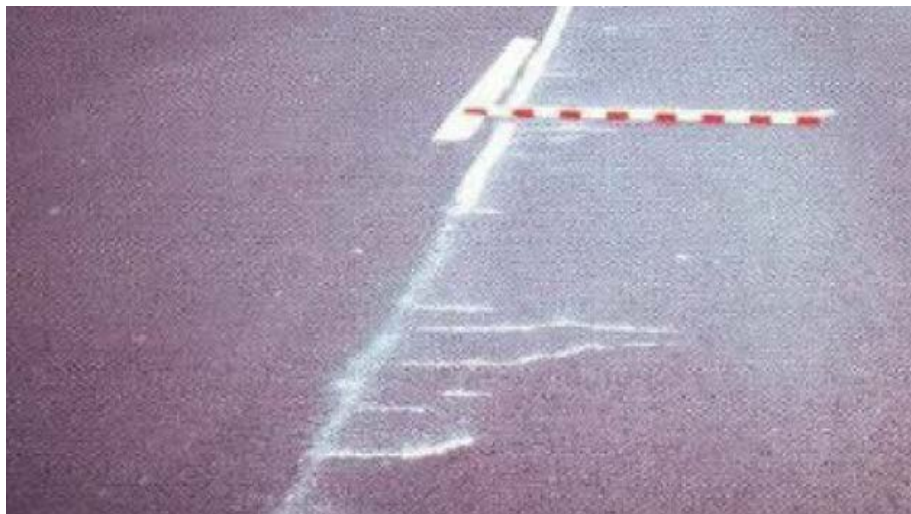
Figure I.12 : Remonté des fines : dégradation franche, significative et étendue (LCPC, 1998).
