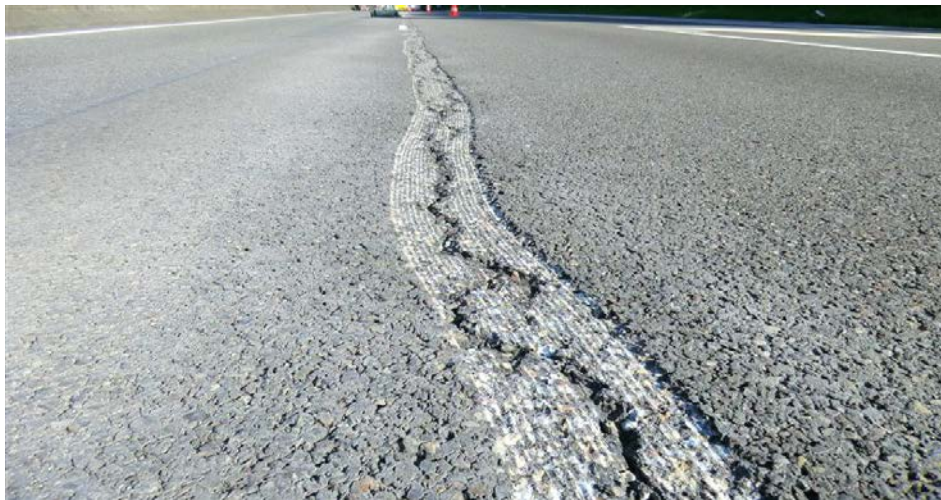
Figure I.9: Fissure au niveau d'une chaussée.
