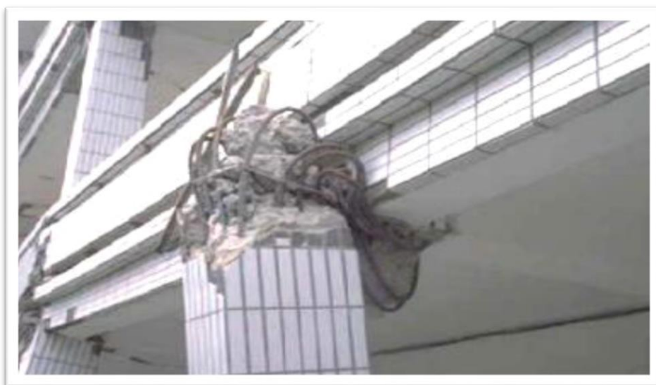
Figure 2. 2 : Éclatement de zones critiques aux extrémités
