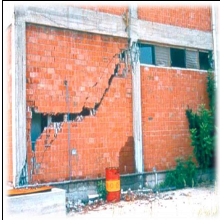
Figure 2. 8 : endommagement de remplissage causant le cisaillement des poteaux.
