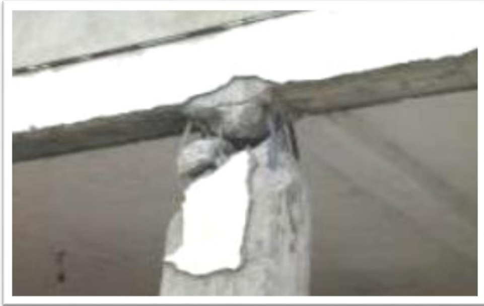
Figure 2. 3 : Dislocation des sections des poteaux poutres
