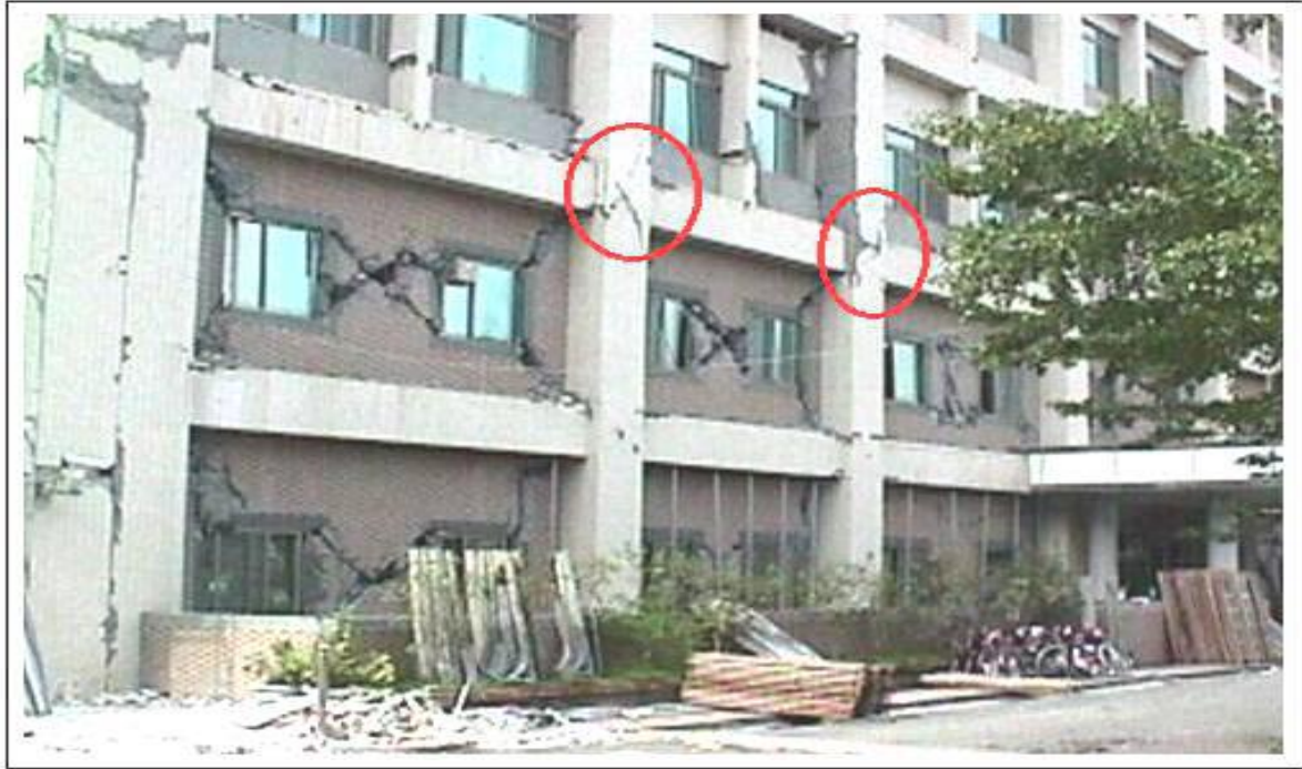
Figure 2. 6 : La propagation des fissures diagonales vers les nœuds du cadre (remplissage assez rigide). Ces dégâts sont de degré 4.
