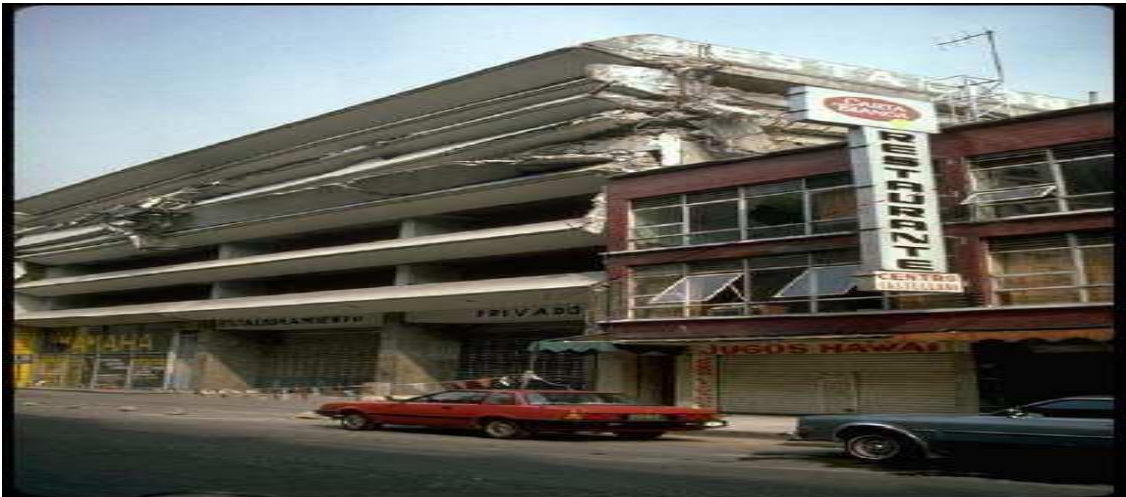
Figure 1. 24 : dommage dus à la présence de niveaux en retrait.
