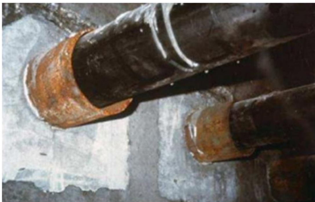
Figure I-4 : Gaines de précontrainte en PEHD au niveau d'un passage de déviateur
