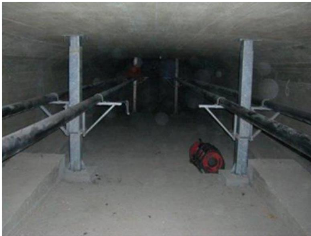
Figure I-3: Conduits de précontrainte extérieure à l'intérieur d'un ouvrage
