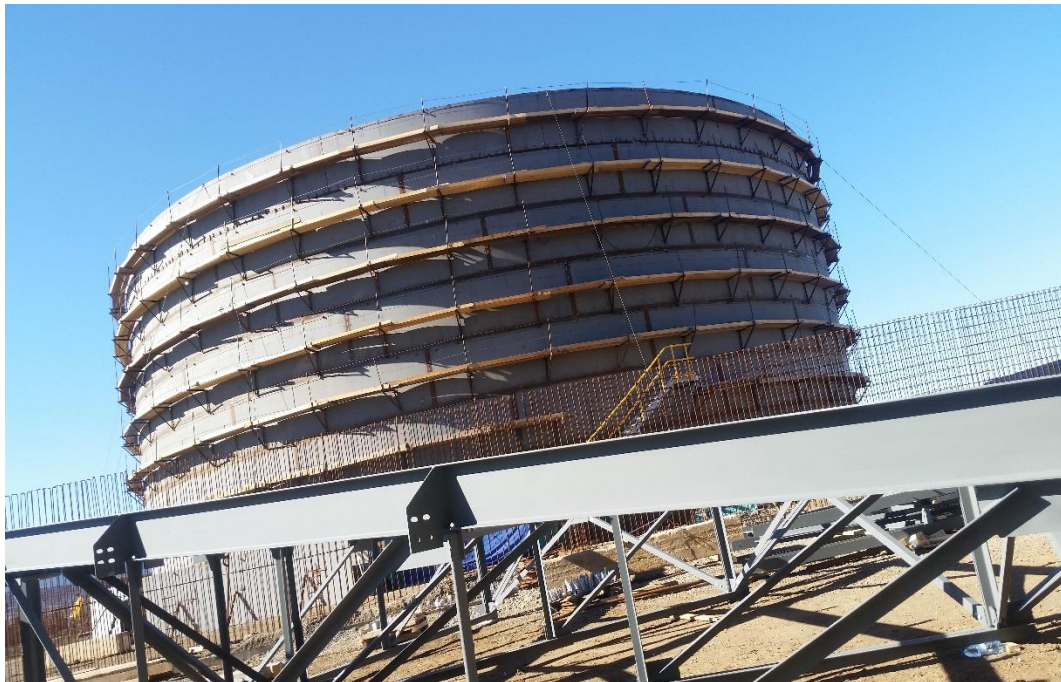
Figure II.1 : réservoir métallique a toit fixe
