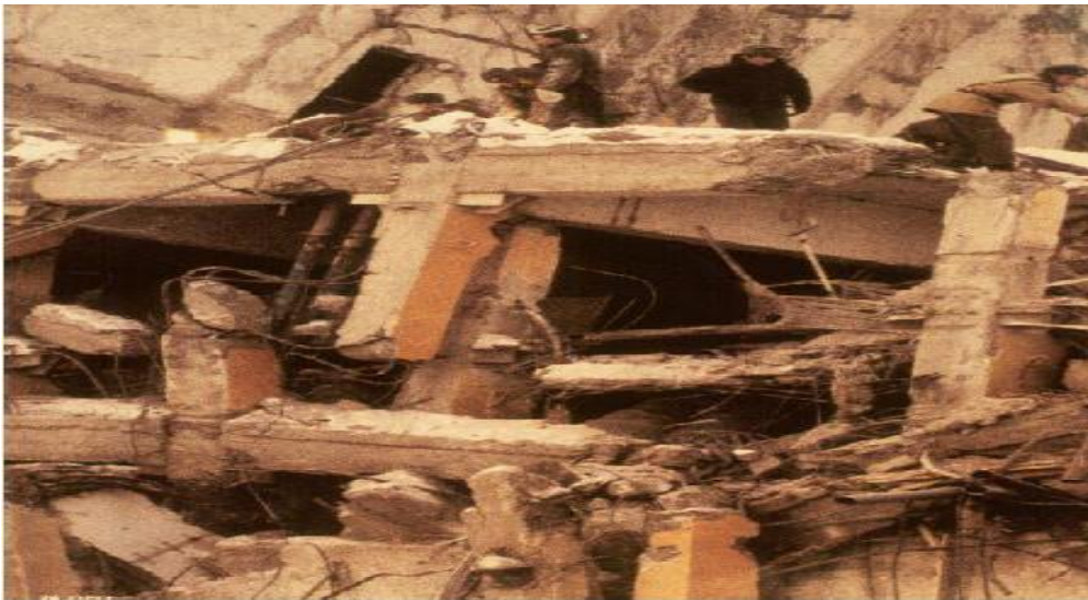
Figure II.9 : Rupture fragile de portiques de béton armé (Arménie) Conception incorrecte des armatures [26]
