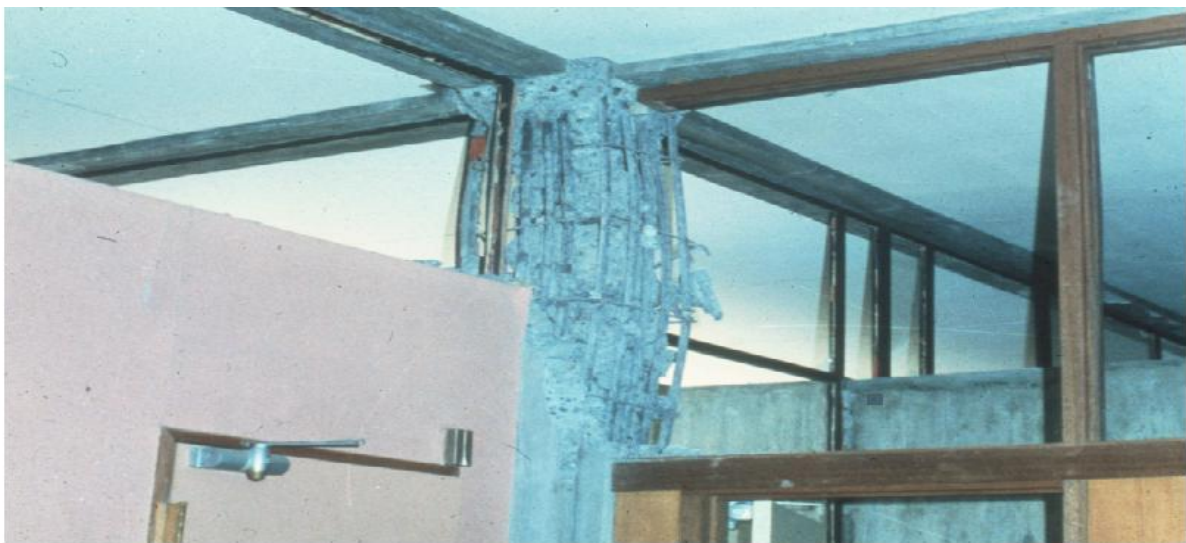
Figure II.21 : Rupture par écrasement du béton du au remplissage partiel [23].
