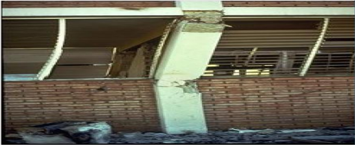
Figure II.20 : Cisaillement du poteau dû au remplissage partiel [23].
