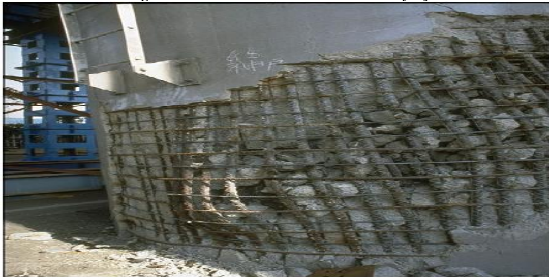
Figure II.23: Kobe béton armé confiné : comportement ductile [23]
