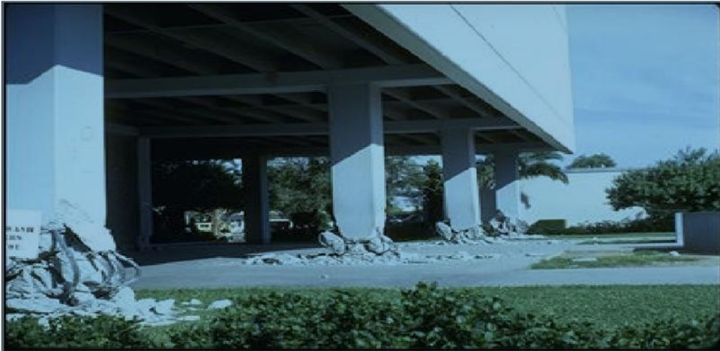
Figure II.8 : Rupture par formation des rotules plastiques aux pieds des poteaux [25]
