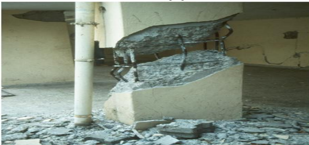
Figure II.10: Rupture pour mauvaise qualité des matériaux (Ceyhan 1998) Rupture en compression du béton de mauvaise composition (dosage, agrégats) et armatures non ductiles [25].
