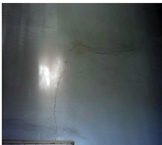
Figure II.1 Lézarde d'un mur
