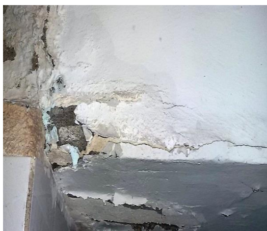
Figure II.3 Infiltration d'eau sous-sol
