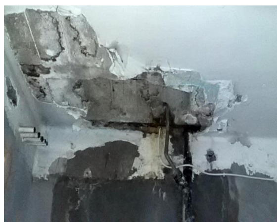
Figure II.4 Infiltration d'eau dernière étage
