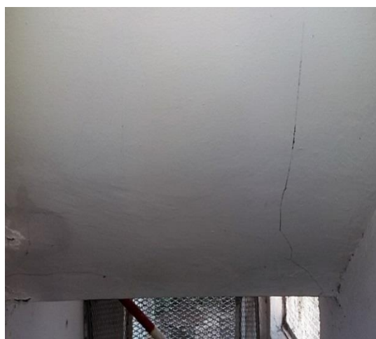
Figure II.2 Fissure au niveau du sous-sol
